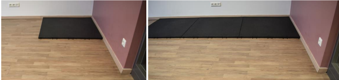
Verlegung der Platten entlang einer graden Wand mit den Steckverbindern nach vorne
