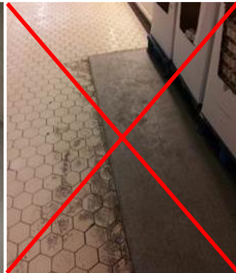
nicht geeigneter Bodenbelag
