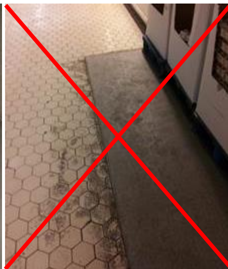
nicht geeigneter Bodenbelag
