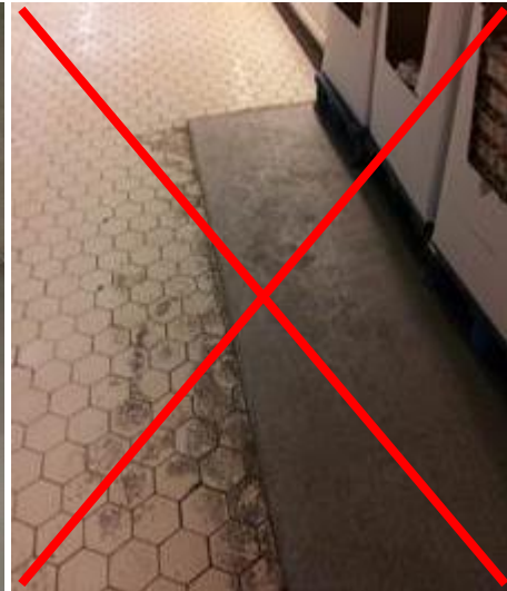
nicht geeigneter Bodenbelag
